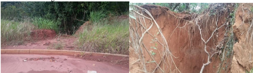
Fotos 4 e 5 – Imagem externa da erosão
